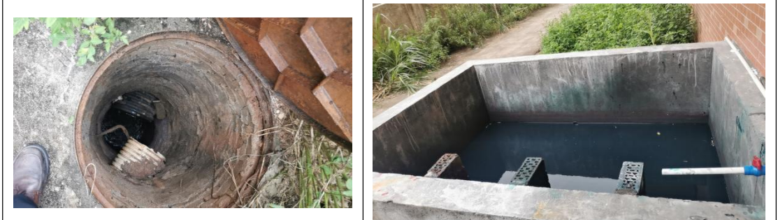
废水处理设施排放口 图 3
