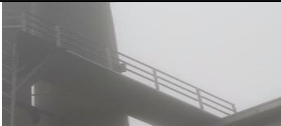
加热炉废气排气筒（DA025）采样平台及采样孔
