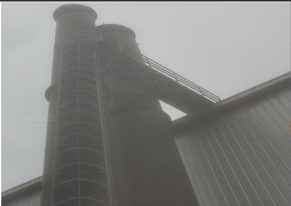
加热炉废气排气筒（DA025）
