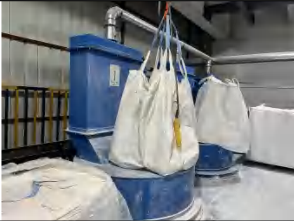
投料口设置袋式除尘措施
