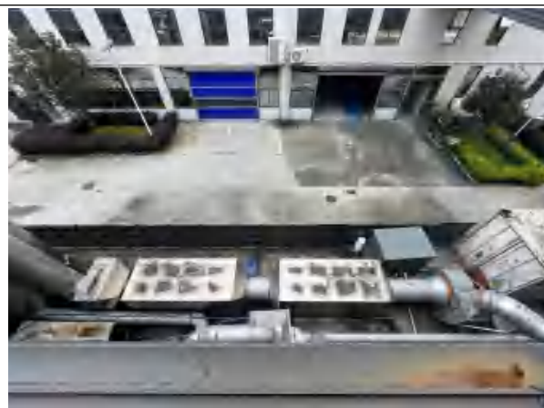
废气处理设施TA001-喷淋塔+除湿除雾干燥器+ 二级活性炭
