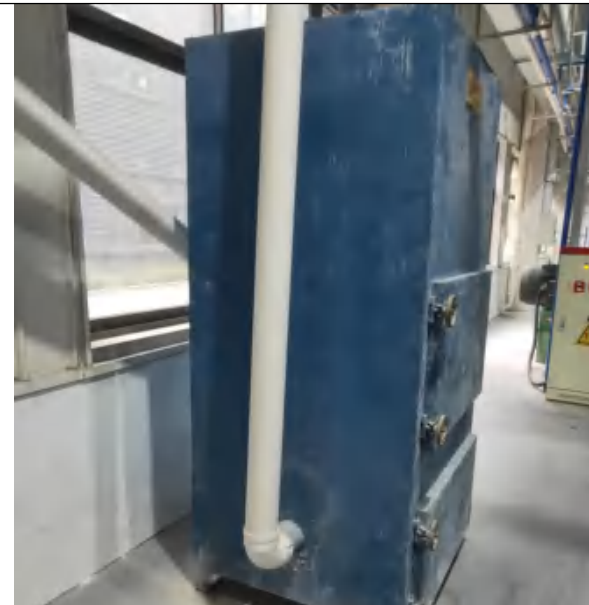
废气处理设施 TA002-布袋除尘器
