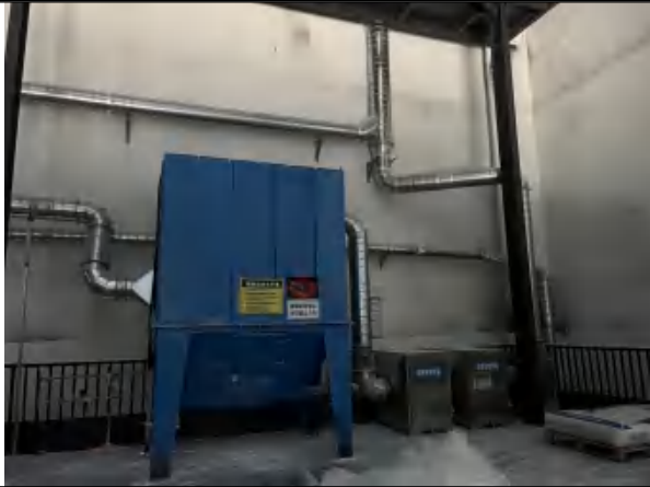
废气处理设施 TA003-布袋除尘器+二级活性炭 废气排放口 3DA003
