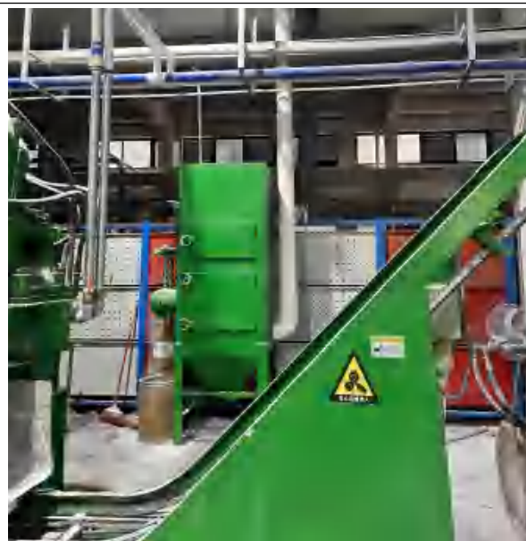
废气处理设施 TA002-布袋除尘器
