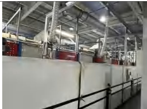
低温隧道炉-设施集气设置
